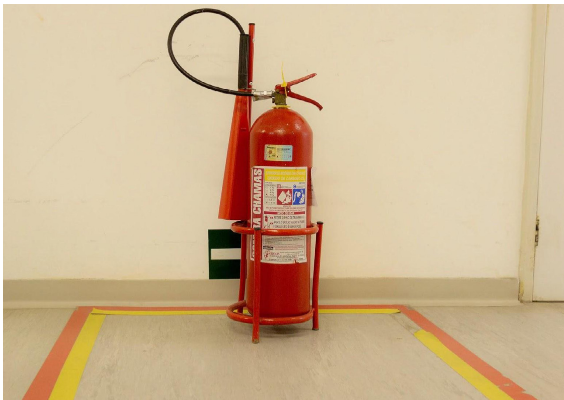
Figura 12 – Extintor de incêndio com área delimitada e classes de extintores
