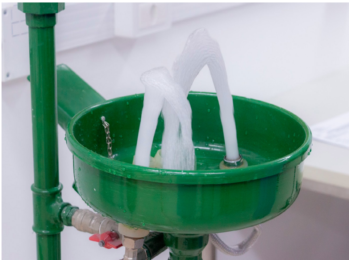
Figura 11 – Dispositivo lava-olhos durante acionamento em laboratório
